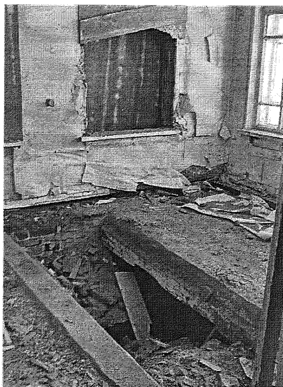
Фото 5 от 28.11.2023. Фрагмент внутреннего помещения первого этажа повреждение полов, промерзание наружных стен, нарушение целостности штукатурного слоя.
