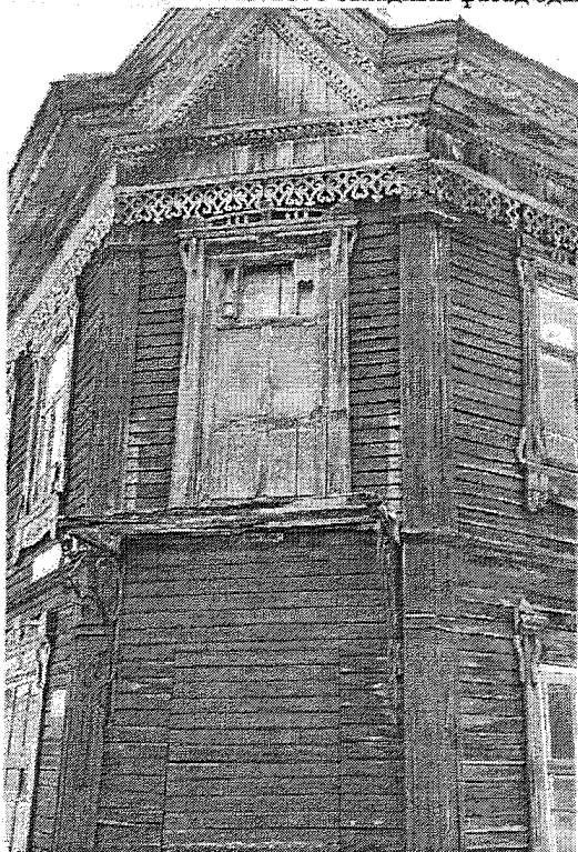
Фото 4 от 28.11.2023. Фрагмент главного фасада, отсутствие балкона в уровне второго этажа.
