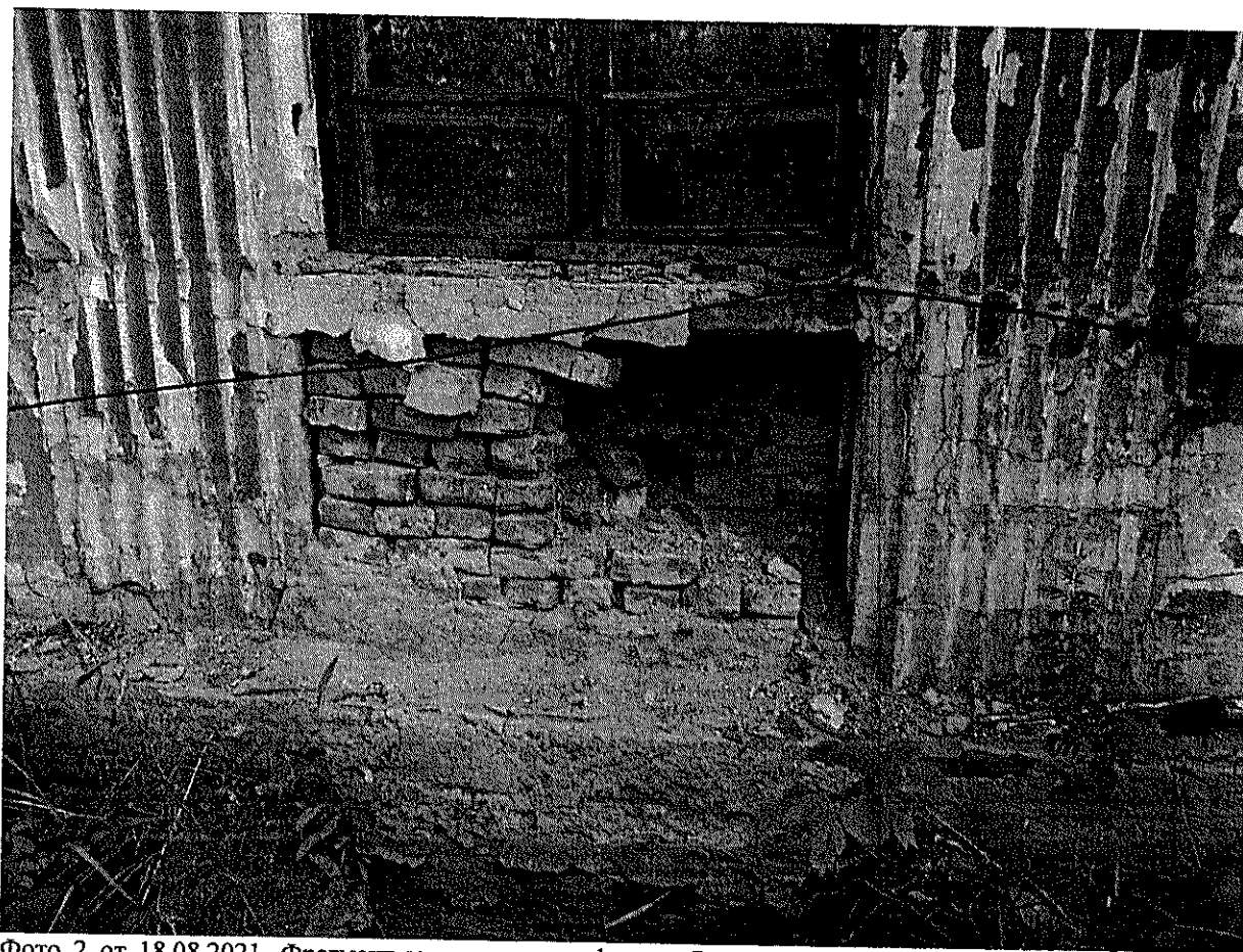
Фото 2 от 18.08.2021. Фрагмент юго-западного фасада. Разрушение кирпичной кладки фасада, повреждение декоративных элементов.
